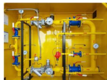
ГРПШ-МОДУЛЬ-С33-2030-У1, оснащенный предохранительно-сбросным клапаном РЕД-25.
