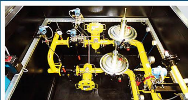
Санкт-Петербург | Новая Голландия | Регулятор давления газа в составе подземного ГРП
