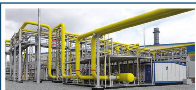
Регуляторы давления газа в составе БППГ Челябинской ГРЭС
